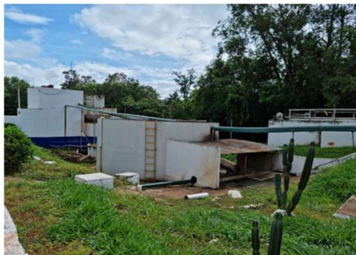
Estação de Tratamento de Efluentes
