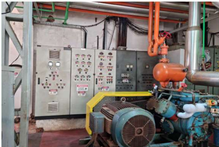
Sala de Máquinas
