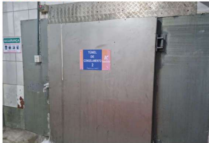
Túnel de Congelamento
