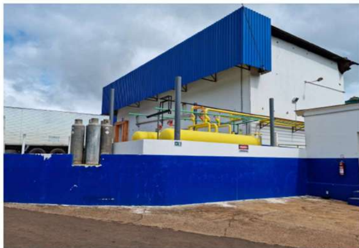
Reservatório de Amônia
