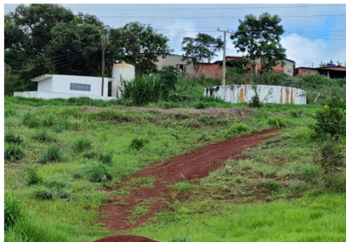
Estação de Tratamento de Água
