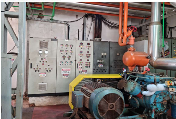
Sala de Máquinas
