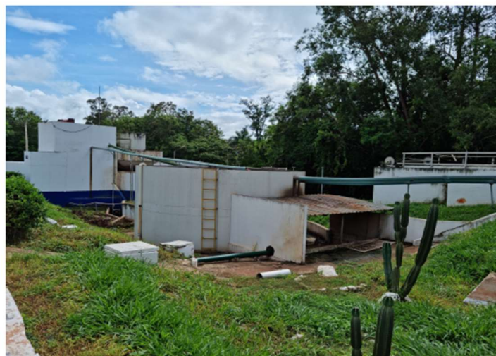
Estação de Tratamento de Efluentes
