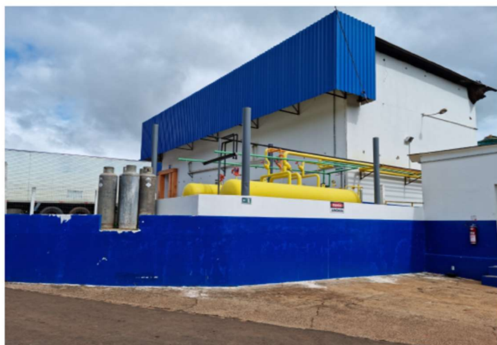
Reservatório de Amônia
